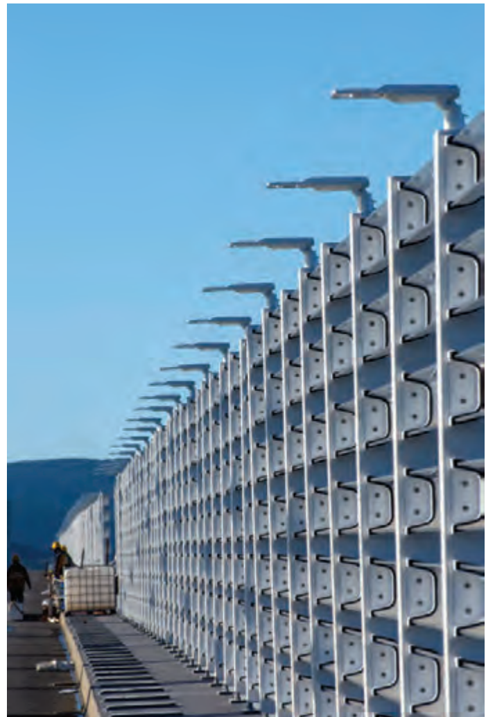
Ograda za zaštitu od vjetra i rasvjeta
